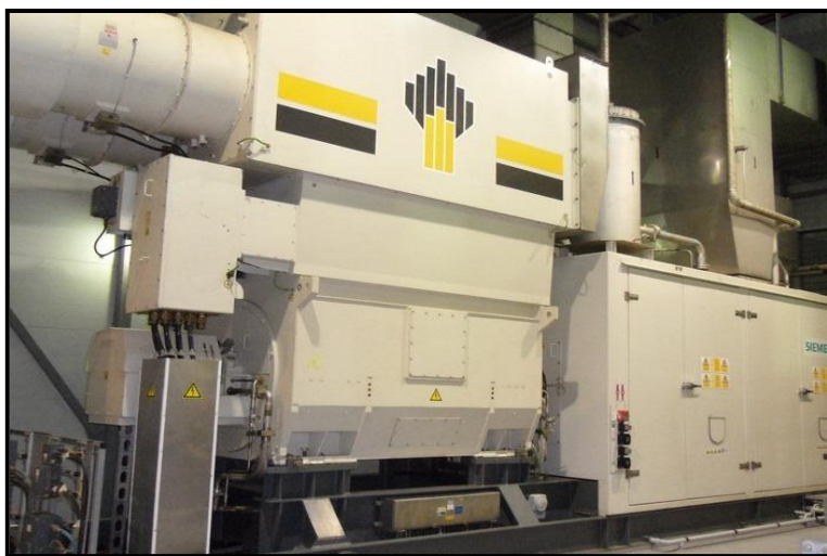
Рис.1. Общий вид газотурбинной установки SGT 300 Tempest 7,9 МВт
